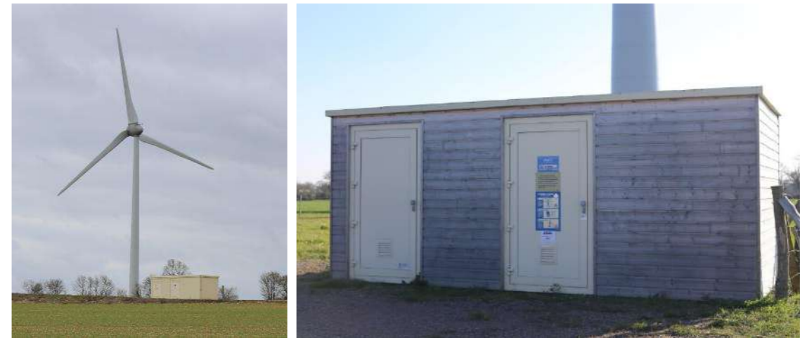
Photo 3 : Exemples de poste de livraison électrique
